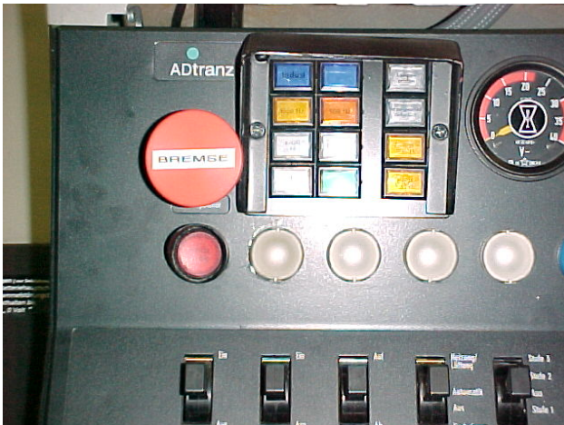
Bild 1: Aufsatz „Bremsse“ über Schlagschalter „Federspeicher“ setzen
