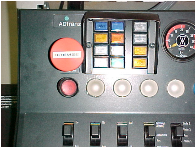
Bild 1: Aufsatz „Bremsse“ über Schlagschalter „Federspeicher“ setzen
